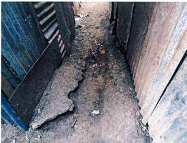
Photo n°3 : érosion, sols non plans, risques de chute
