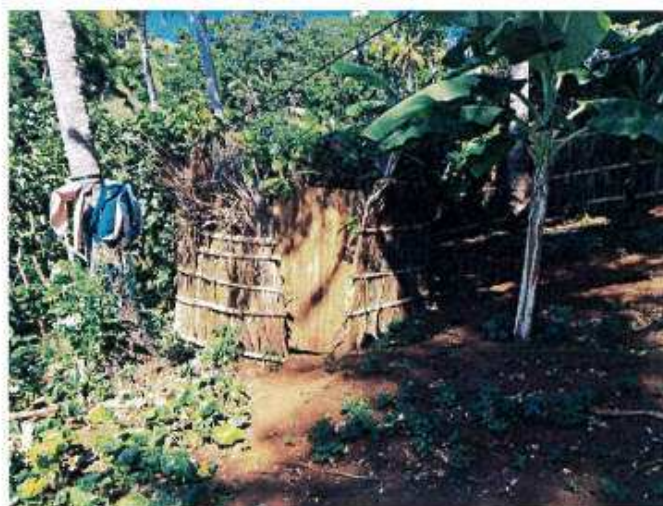
Photo n°19 : exemple de local sanitaire, absence de toiture
