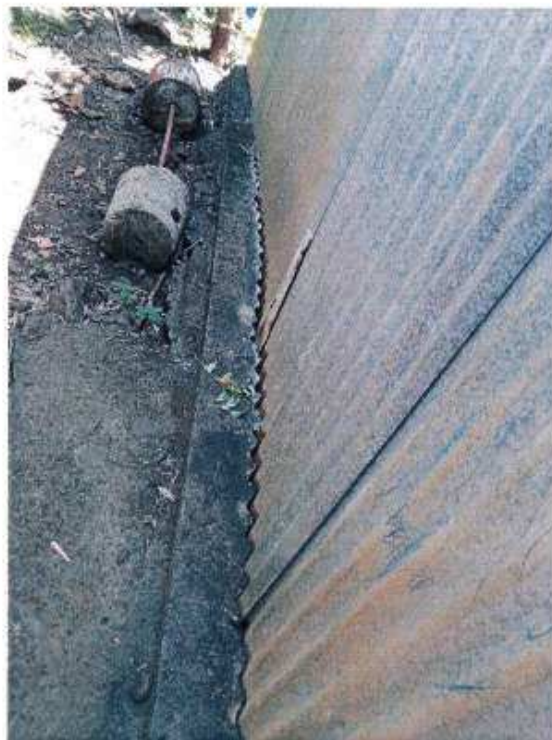
Photo n°9 : béton projeté sur l'embase des constructions, absence d'étanchéité
