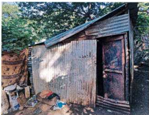
Photo n°5 : construction dépourvue de fondations, tôle clouée sur structure en bois, manque d'éclairage naturel dans la pièce de vie
