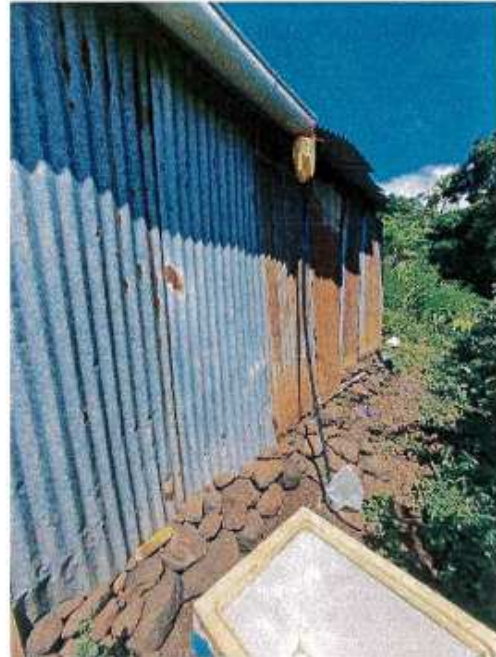
Photo n°26 : installation sommaire de récupération d'eau pluviale
