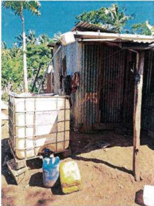
Photo 25 : installation sommaire de récupération d'eaux pluviales
