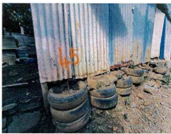
Photo n°8 : absence de fondations, pneus soutenant la construction
