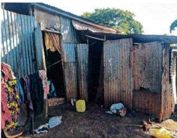
Photo n°7 : assemblage de tôles dégradées, non jointives
