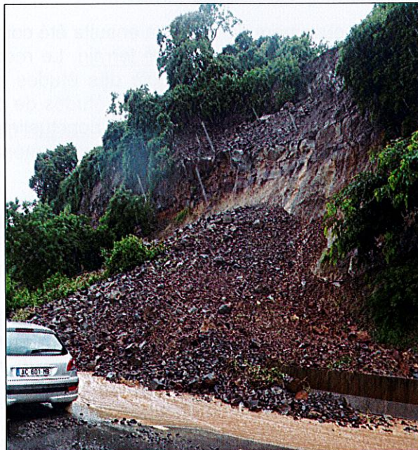
Illustration 7 - Glissements de terrain du 8 février 2012 sur la RN1 à proximité de Koungou (sources photographies BRGM)
