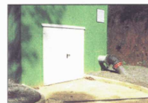
Photo 8 : Seuil de Bouyouni Bas, Juin 2003. Station de pompage. BRGM Mayotte
